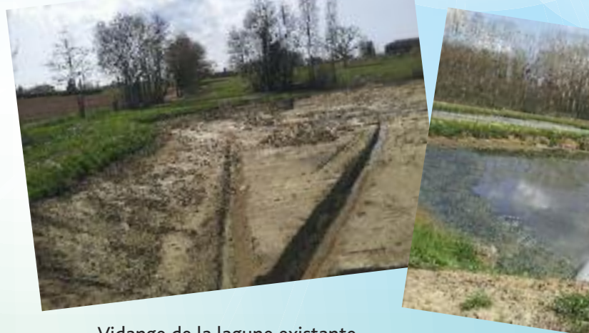
Vidange de la lagune existante et mise en place de la solution transitoire qui durera plus longtemps que prévu en raison de la météo !
